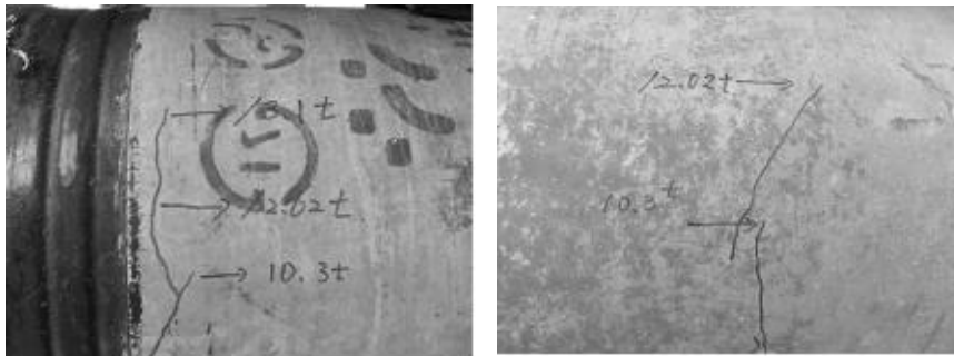
그림 7. 연결부 bending 시험시 PHC 말뚝 균열 발생 사진
